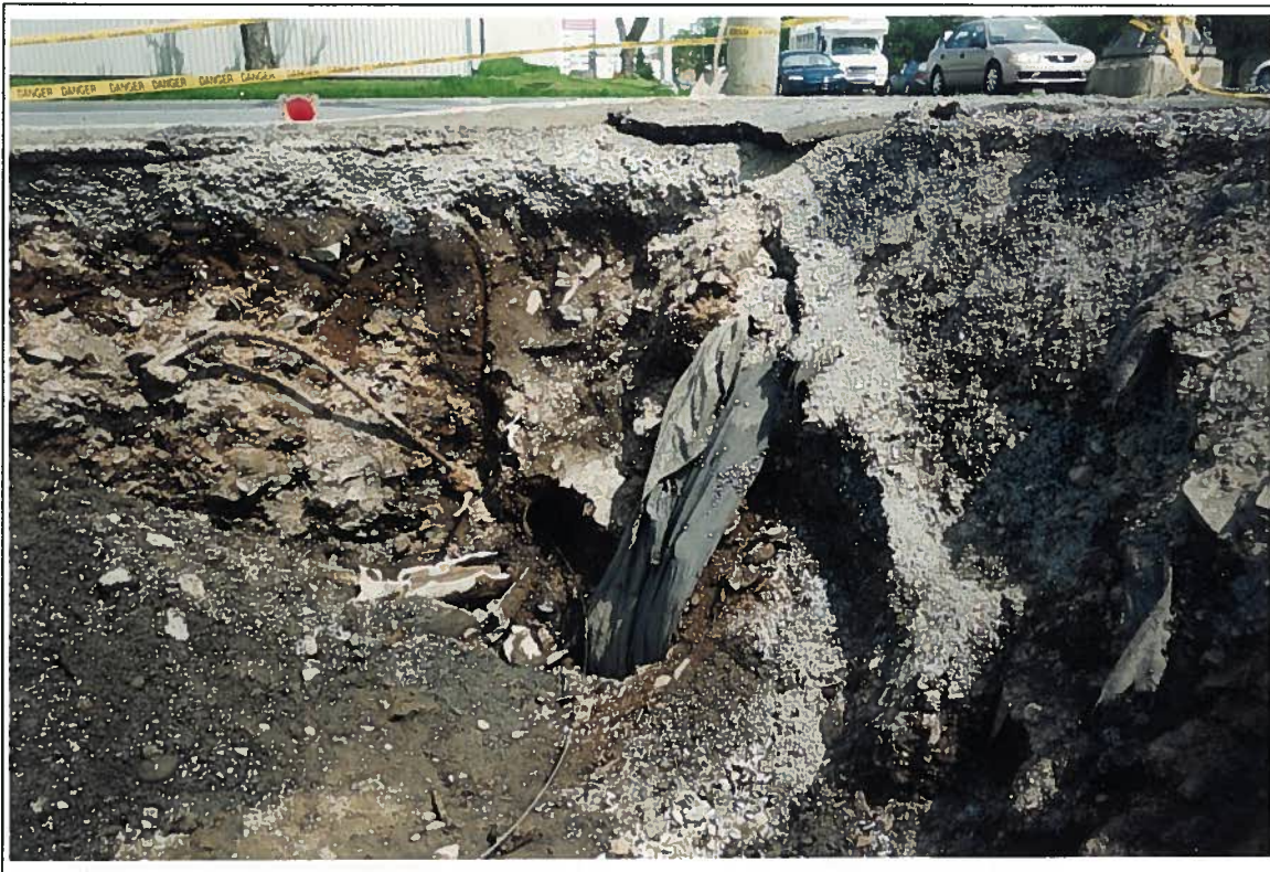
Photo 22 : Entrée d'eau et d'égout condamnée en juin 2003
